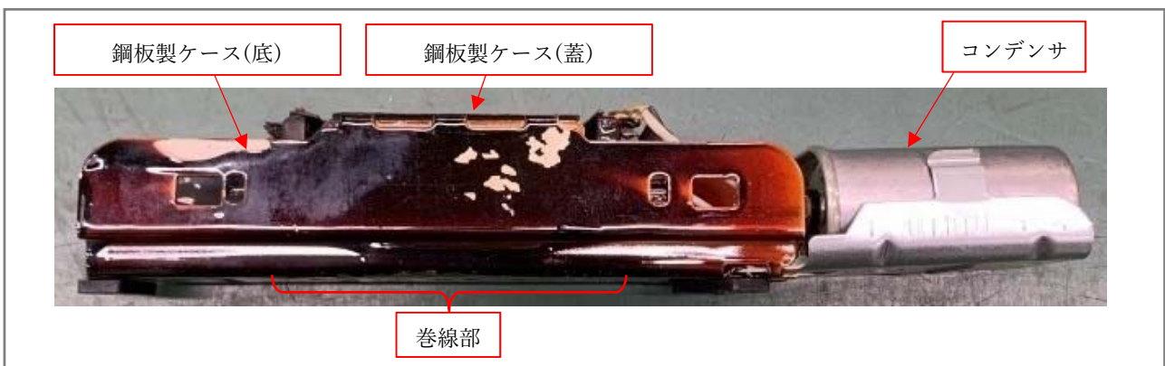
写真7：安定器外観（側面）
