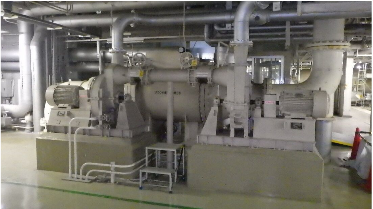
グラント蒸気復水器排気ファン本体 (右：3A、左：3B)
