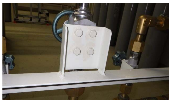
【参考】 類似設備の弁の取り付け状態
