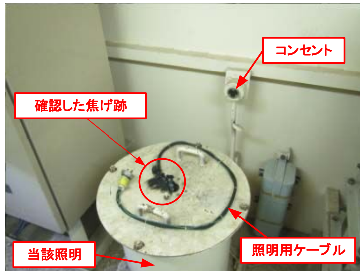
照明用ケーブル焦げ跡(ガーダ内部)
