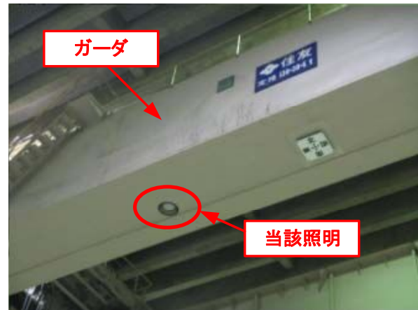
タービン建家天井クレーン1号機(拡大)
