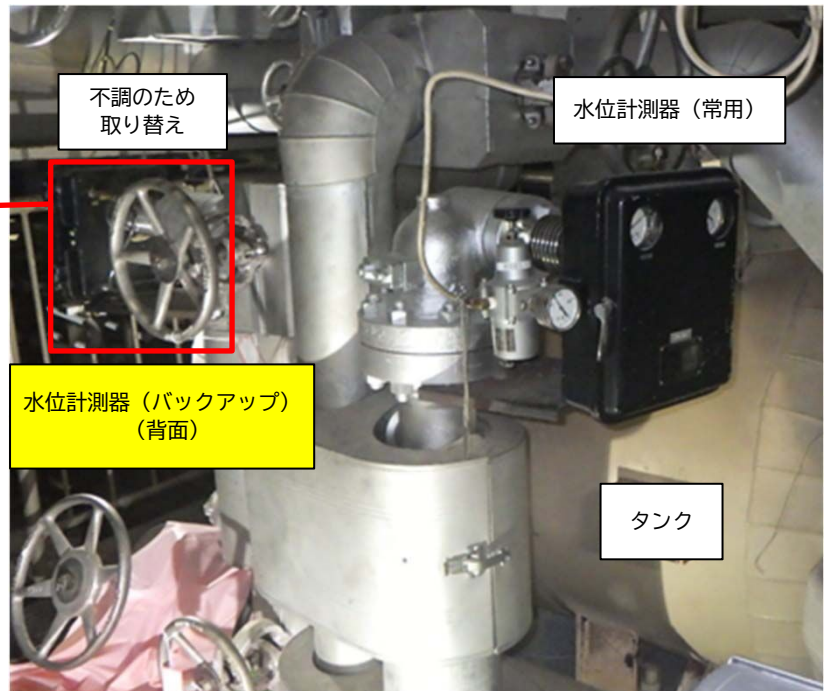
第2段湿分分離加熱器ドレンタンク3A1の全体写真
