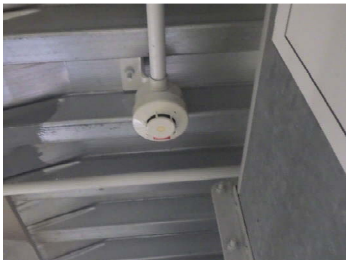
火災感知器(セメント固化装置エリア)
