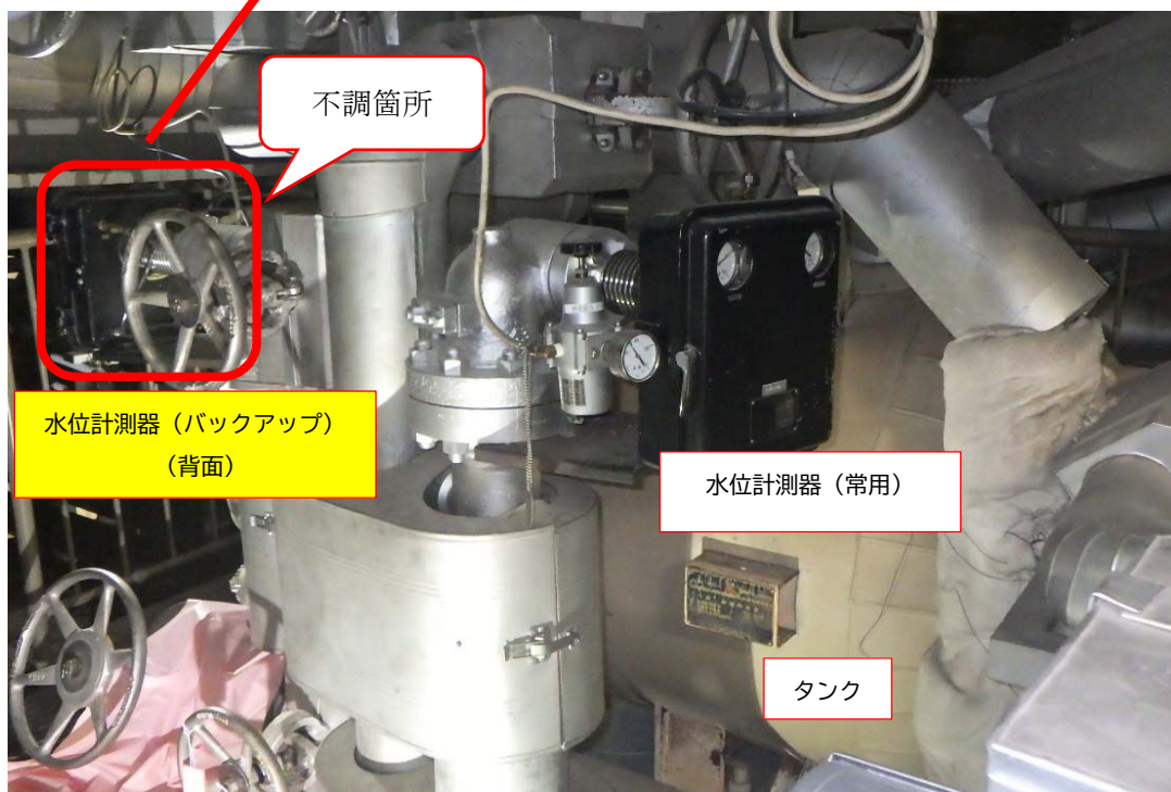
第2段湿分分離加熱器ドレンタンク 3A1 の全体写真
