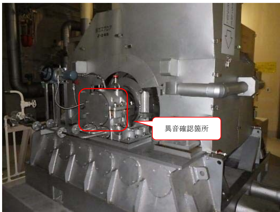
ブロア側の写真（A矢視）
