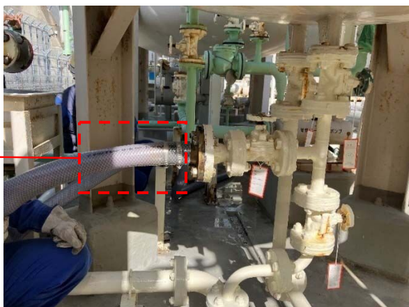
塩酸抜き取り作業時の状態
