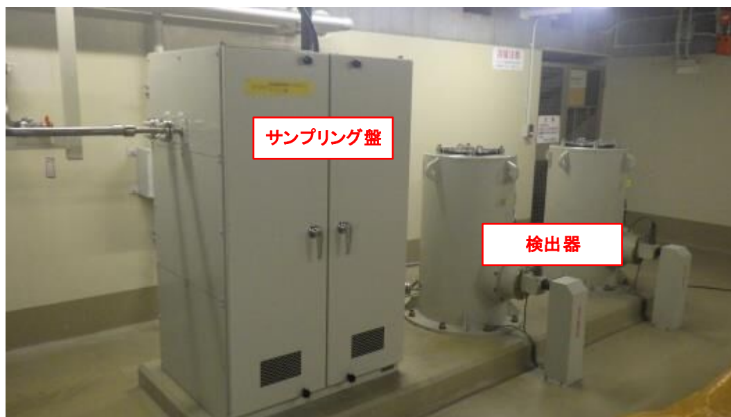
補助建屋排気筒高レンジガスモニタ
