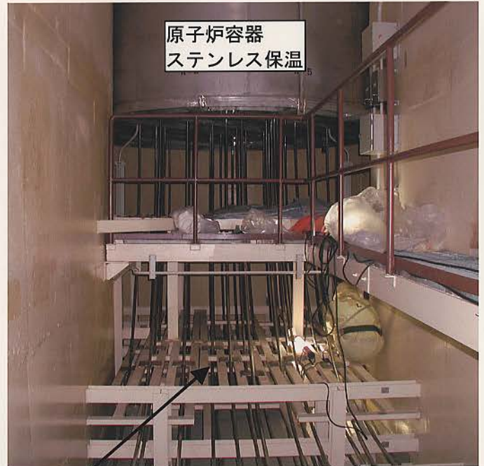
シンプル案内管 汚れ付着状況①
