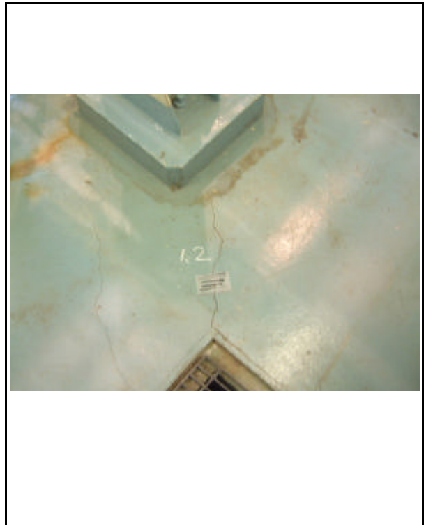
3号機 純水装置建家内床
