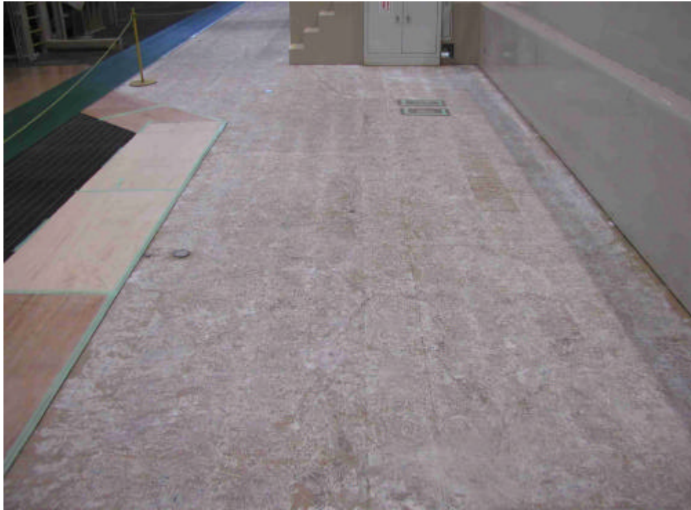
タービン架台 上面のひび割れ（長さ13mの部分・海側）
