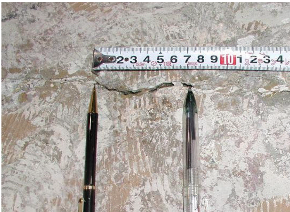
ひび割れ幅 最大の部分（3～4mmで局部的・長さ7cm程度）
