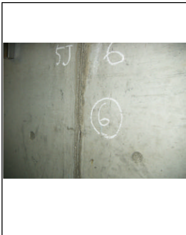
3号機ケーブルダクト
