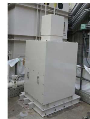
耐震型海水ピット水位計 (電波式)
