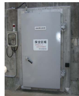
水密扉(海水ピット) (当初自主設置)
