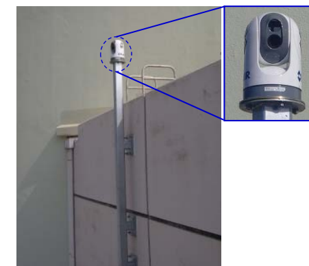
海面監視カメラ (中央制御室にて監視)
