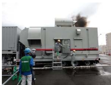
空冷式非常用発電設備
