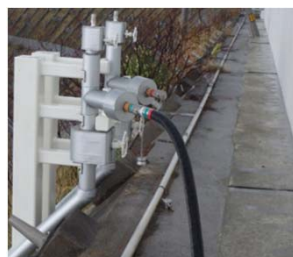
重油移送配管
