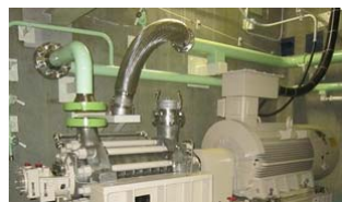
蒸気発生器代替注水ポンプ (自主設置)
