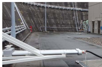
軽油移送配管
