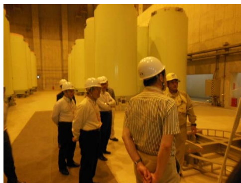
乾式貯蔵施設内 (奥に見える円筒が乾式キャスク)
