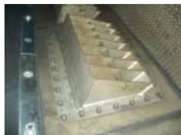
マニホールド付近点検状況 (点検箇所 も同様)
