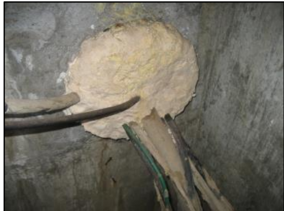
(ケーブル：貫通部番号 1-AB-SE-1)
