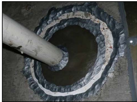
(電線管：貫通部番号 2TB-E-25)
